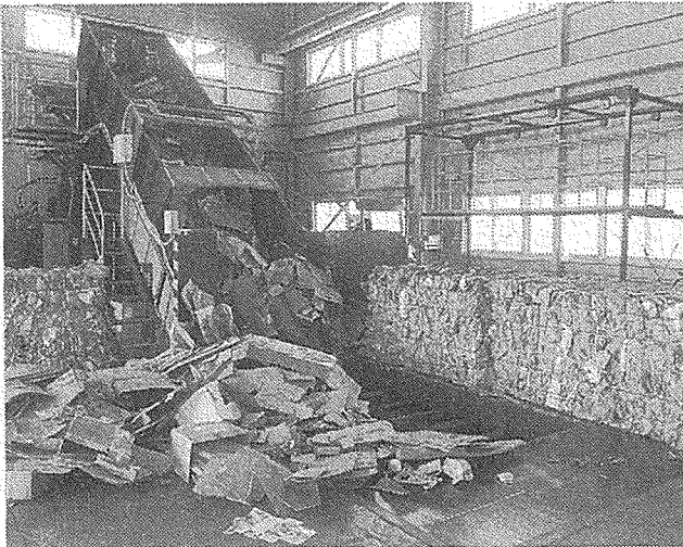
ホームックスが導入した古紙用圧縮梱包設備
